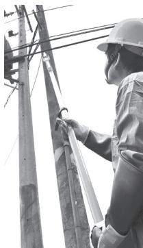
Fig. 3 : Détection de tension dans des lignes de transmission aériennes
